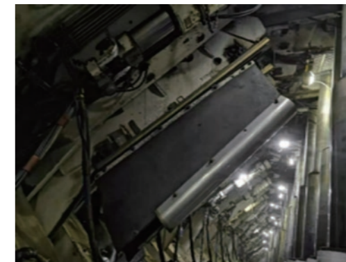
滑移式支架封闭导尘装置
